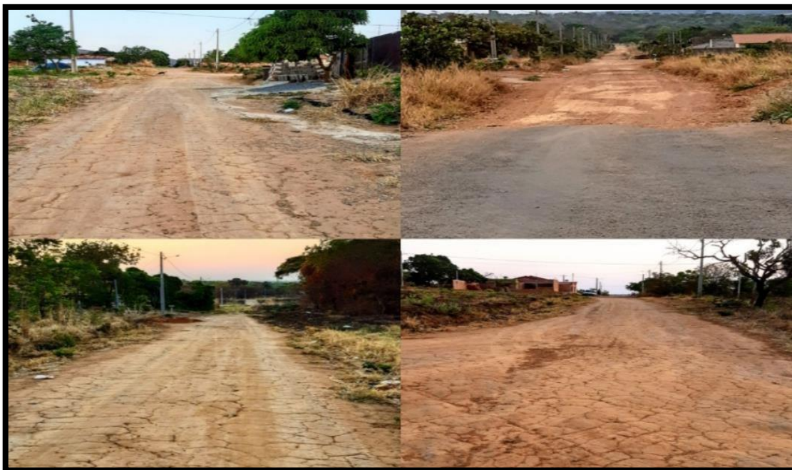
Figura 03 - Ruas em estado precário do bairro Fauna 2.
