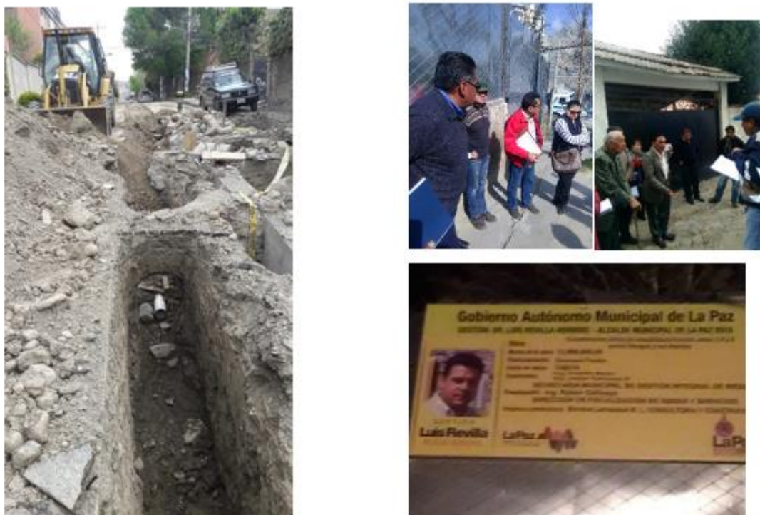
Figura 3. Comunidades en acción Deslizamiento Calles 4 y 5 zona Obrajes, Ciudad La Paz (2018-2019).
