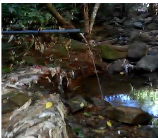
Figura 6: Lançamento clandestino de esgoto na via hídrica Fonte: Autores, 2017
