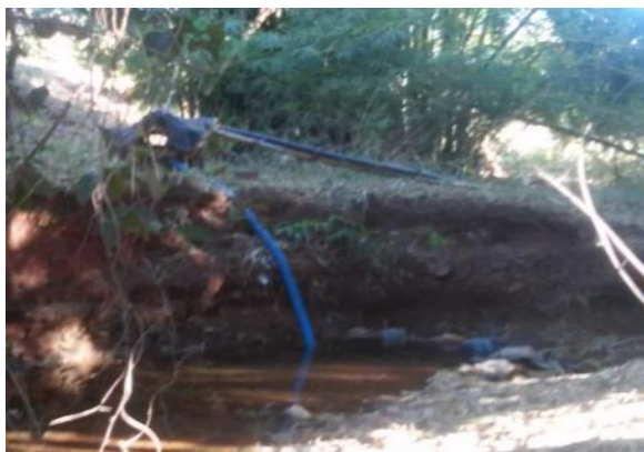
Figura 8: Retirada d'água em margem erodida do curso fluvial Fonte: Autores, 2017
