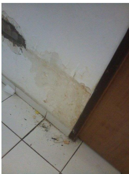
Figura 7 - Infiltração no roda pé, da parede de alvenaria - Pavimento Térreo. Imagem: CAMPOS, 2015
