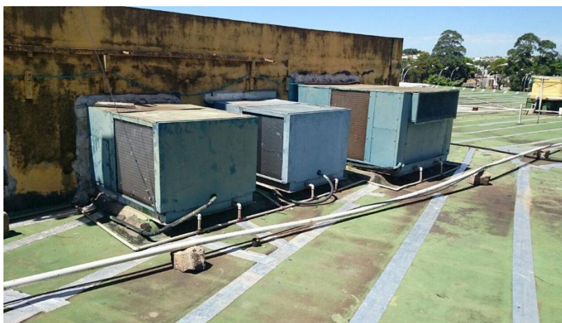
Figura 17 – Manchas nas paredes externas da saída – Cobertura Imagem: CAMPOS, 2015
