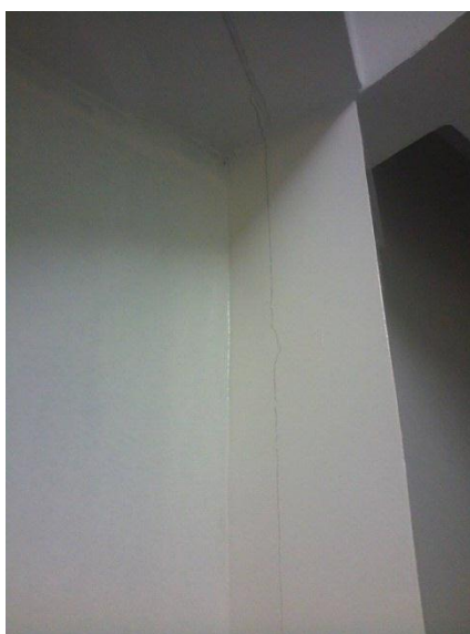
Figura 5 - Fissura no centro do pilar e da vigas circulares - Pavimento Térreo Imagem: CAMPOS, 2015
