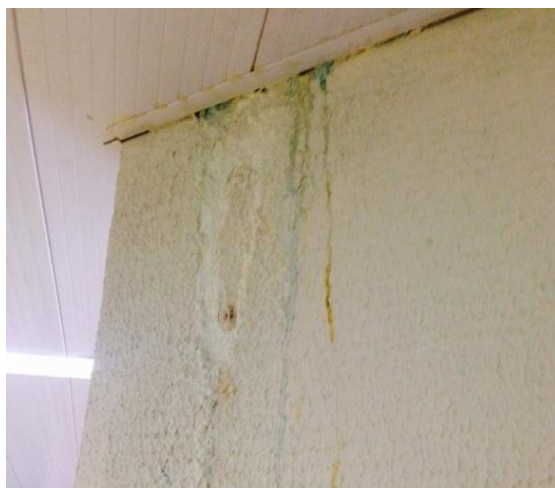
Figura 11 - Eflorescência nos pilares da recepção do Gabinete do Prefeito - Pavimento Superior Imagem: CAMPOS, 2015
