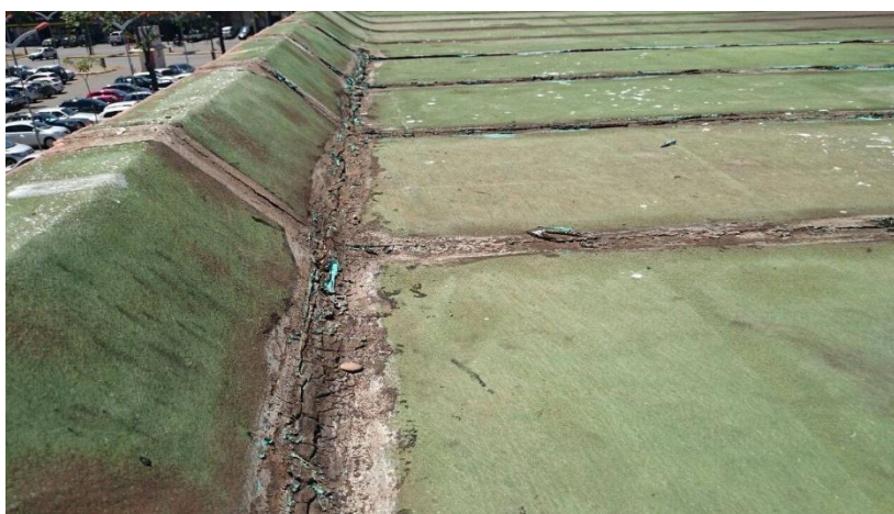
Figura 14 - Manta asfáltica deteriorada – Na área de cobertura da PMA Imagem: CAMPOS, 2015
