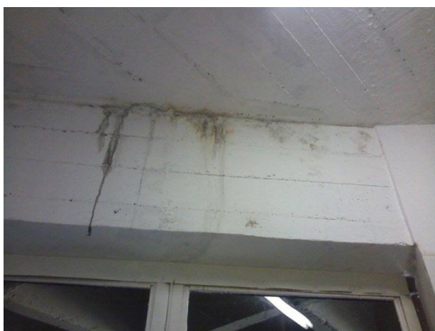
Figura 10 - Infiltração na viga do banheiro feminino - Pavimento Superior Imagem: CAMPOS, 2015
