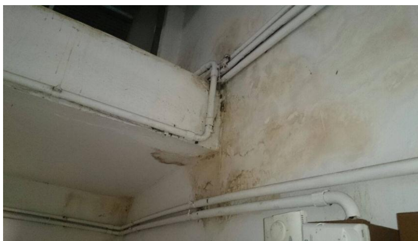
Figura 12- Infiltrações na viga da central de ar condicionado - Pavimento Superior Imagem: CAMPOS, 2015
