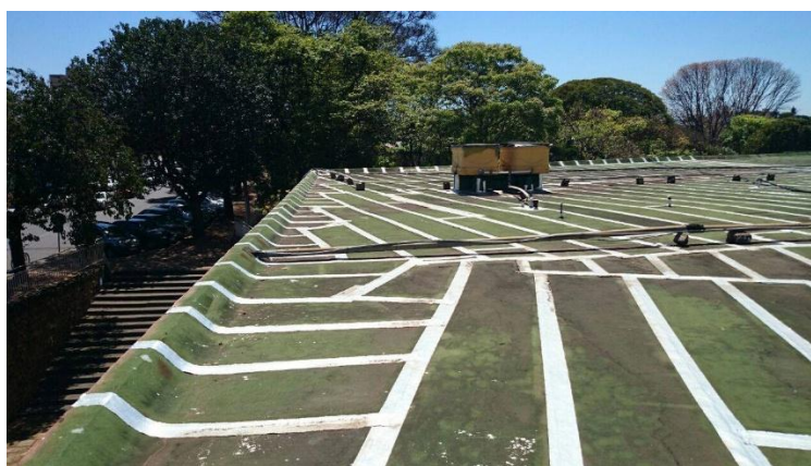
Figura 15 - Manchas na manta asfáltica – Cobertura Imagem: CAMPOS, 2015
