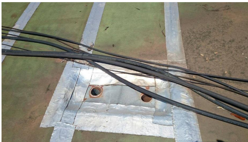
Figura 16 – Duto de queda com presença de cabeamento – Cobertura Imagem: CAMPOS, 2015
