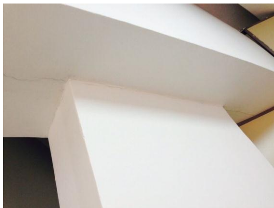
Figura 6 - Fissura passando pelo pilar e entre as vigas circulares - Pavimento Térreo Imagem: CAMPOS, 2015
