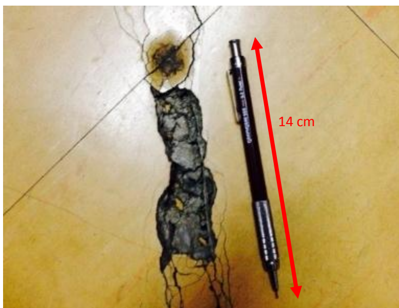
Figura 8 - Dimensão da rachadura aberta no piso - Pavimento Superior Imagem: CAMPOS, 2015
