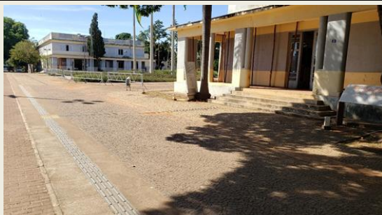
Figura 08: Piso tátil danificado no interior da praça.
