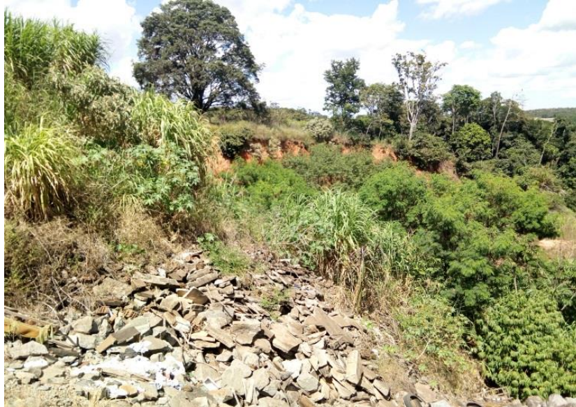
Figura 6. Vista da borda esquerda da “Voçoroca da Ferrovia” com vegetação ruderal e entulhos.
