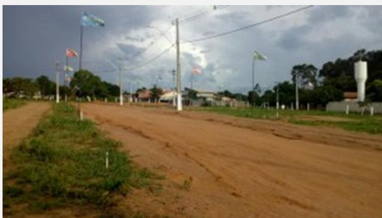
Figura 8 – Rede elétrica instalada no loteamento Jardim dos Ipês. Fonte: El.Dorado (2017).
