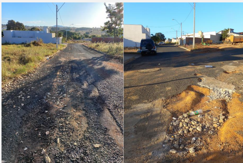
Figura 11 – Asfalto implantado no loteamento, com britas soltas e buracos. Fonte: Os autores.
